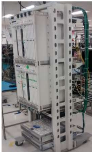
Figura 1. Muestra el Frame que se ensambla en las celdas de manufactura
