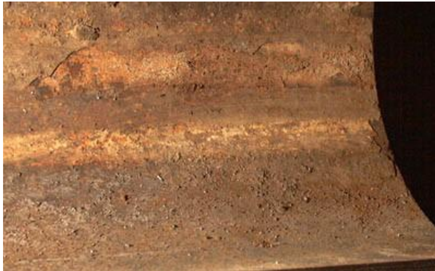
Figura. 2.14 Fotografía de la corrosión uniforme/general
