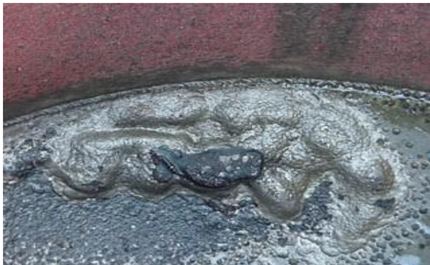
Figura. 2.17 Fotografía de varias picaduras que se han interconectado y que aún están cubiertas parcialmente por producto de la corrosión
