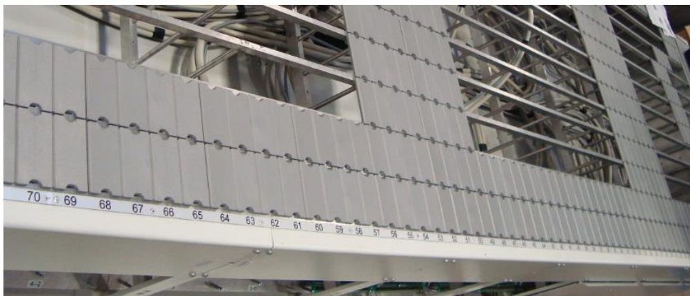
Figura 17. Vista de un ensamble de coordenadas, estación de prueba eléctrica.
