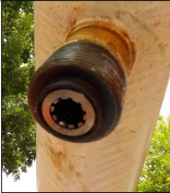
Figura 27. Tapón Sólido Rediseñado en Operación. Se puede apreciar que ya no cuenta con la tuerca externa.
