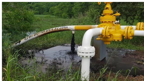
Figura 1. Acto Vandálico debido al retiro de Tapón Sólido del Niple Cosasco® (área contaminada).
