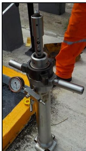
Figura 8. Equipo "retriver" para retiro/inserción de cupones corrosimétricos
