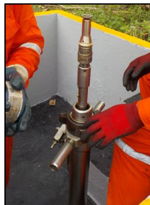
Figura 10. Colocación de porta-cupón con testigo corrosimétrico circular en "tapón sólido" instalado en equipo "retriver".
