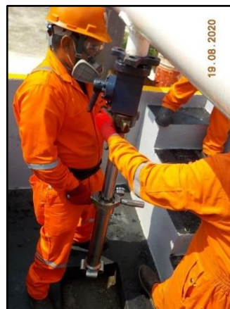
Figura 11. Vista de la inserción/retiro de cupón corrosimétrico.
