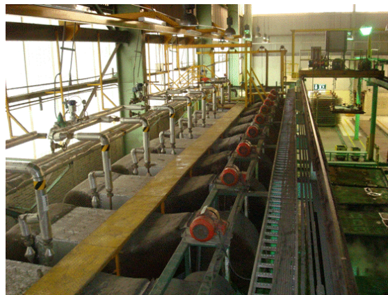
Figura 40. Vista superior del horno de inducción. Elaboración propia.
