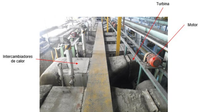
Figura 39. Detalle del motor de turbina e intercambiadores de calor. Elaboración propia.
