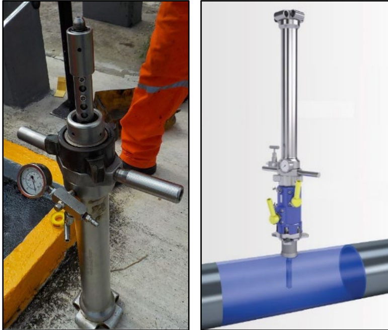
Figura 13. Herramienta "retriver" para retiro/inserción de cupones corrosimétricos Elaboración propia/ (Cosasco, 2021)
