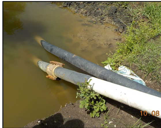
Figura 34. Colocación de grapa-camisa bipartida atornillada marca PLIDCO (Split-Sleeve) en acto vandálico debido a seguetazo. Elaboración propia
