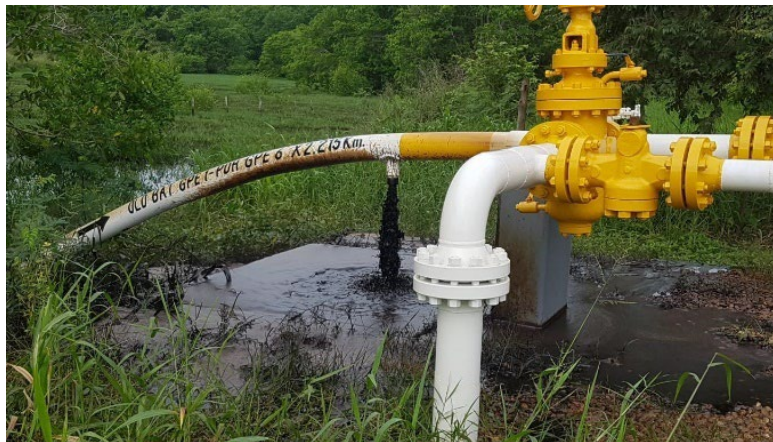
Figura 1. Acto Vandálico debido al retiro del tapón sólido del Niple Cosasco® (área contaminada). Elaboración propia
