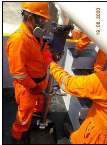
Figura 15. Inserción/retiro de cupón corrosimétrico. Elaboración propia
