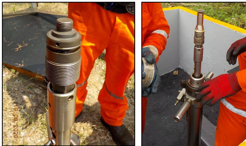
Figura 14. a) "Tapón sólido" instalado en la parte superior del equipo "retriver" (Izquierda), b) porta-cupón y cupón corrosimétrico instalados en tapón sólido del equipo retriver (derecha).
