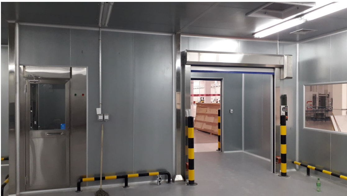
Figura 38. Área de entrada y salida de personal, además de entrada y salida de material. Elaboración propia.
