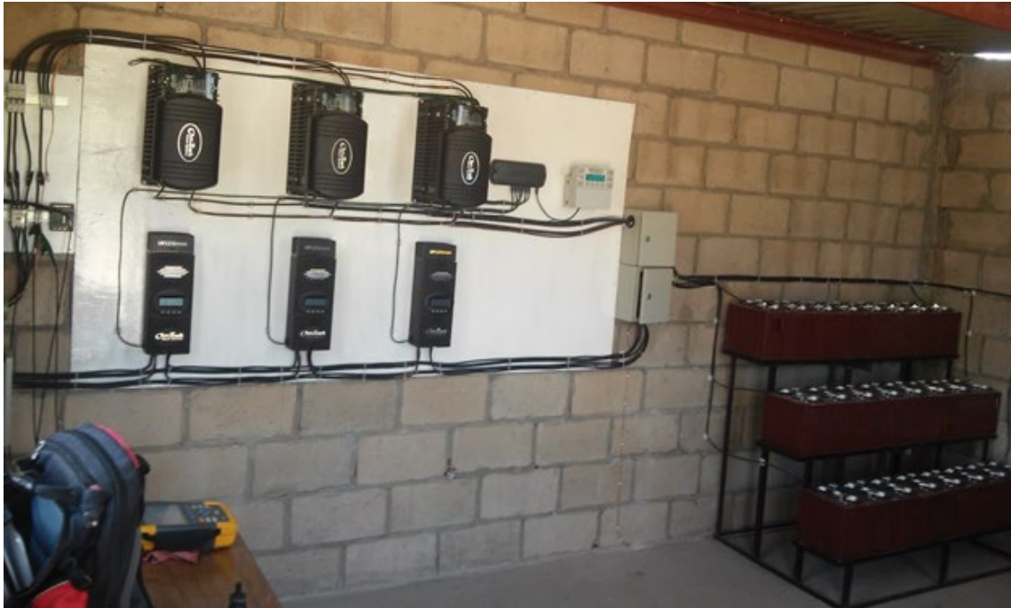
Figura 15. Sistema FV con almacenamiento de energía integrado Tomada de trabajo de campo.
