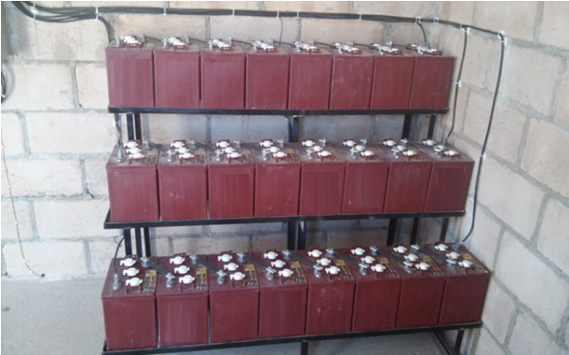
Figura 14. Sistema de almacenamiento de energía Tomada de trabajo de campo.
