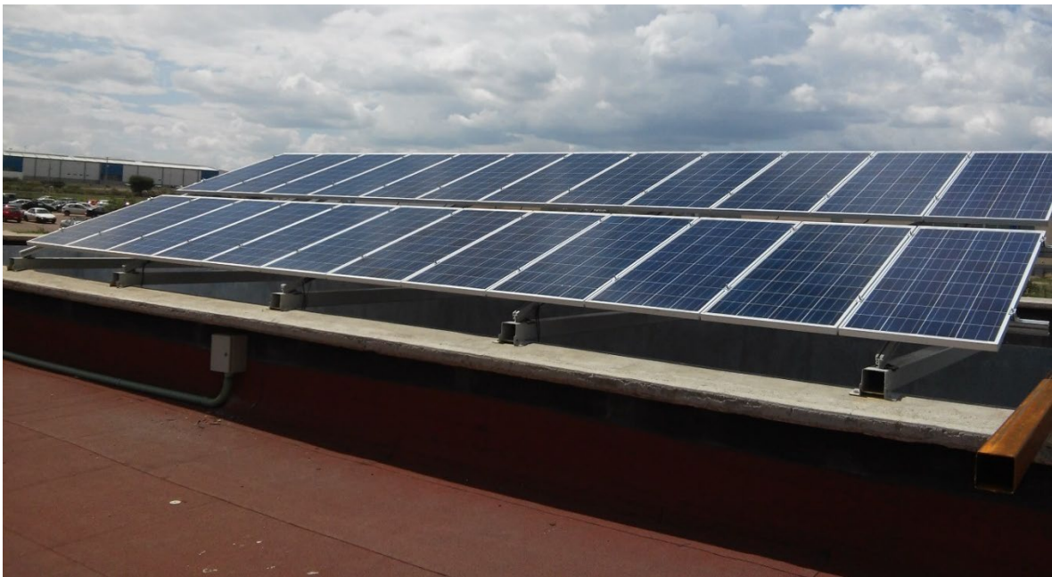
Figura 12. Paneles solares instalados Tomada de trabajo de campo.
