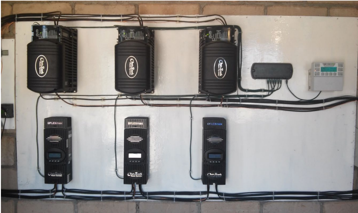
Figura 13. Inversor/cargador, regular y sistema de control instalados. Tomada de trabajo de campo.
