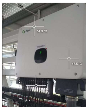
Fig. 7. Inversor en correcta operación.
