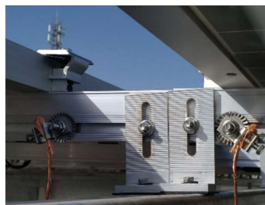
Fig. 8. Estructura debidamente aterrizada.
