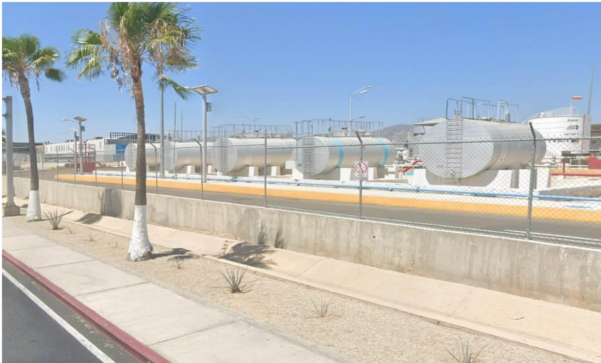
Fig. 1. Tanques atmosféricos de tipo horizontal con sus sistemas de seguridad auxiliares (Fuente Google Maps).
