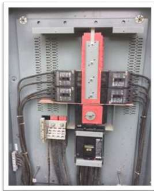
Figura 16. Tablero Eléctrico E-4 ITSLV
